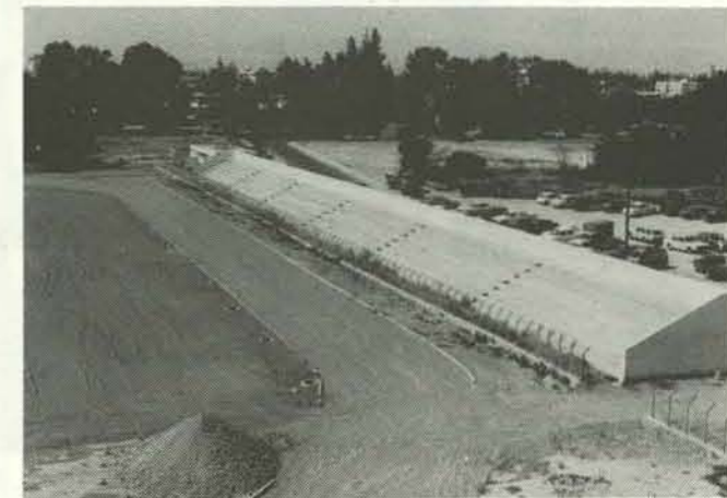
Το Γήπεδο Αθλοπαιδιών των Γυμνασίων της περιοχής Κύκκου, που κατασκευάζει η Εφορεία Ελληνικών Εκπαιδευτηρίων Λευκωσίας, με τεχνική βοήθεια και εισφορά του ΚΟΑ από £25,000.
